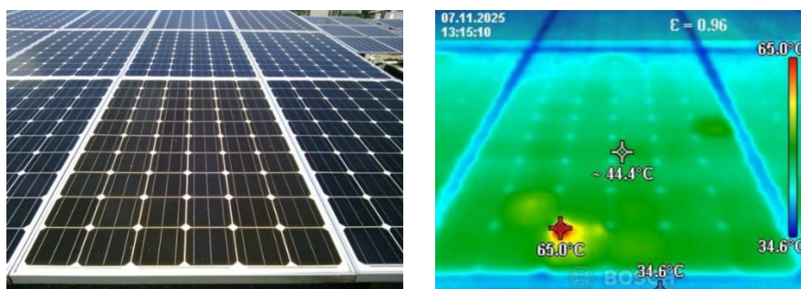
Gambar 2. Fenomena hotspot pada PV modul menggunakan thermal camera.
